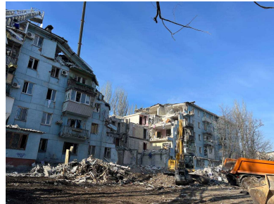
露軍のミサイル攻撃により破壊されたザポリジヤ市の集合住宅（2023年3月） 【ウクライナ緊急事態庁】
