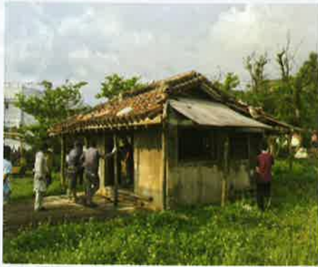
台風被害で屋根瓦が崩れ落ちた本殿
